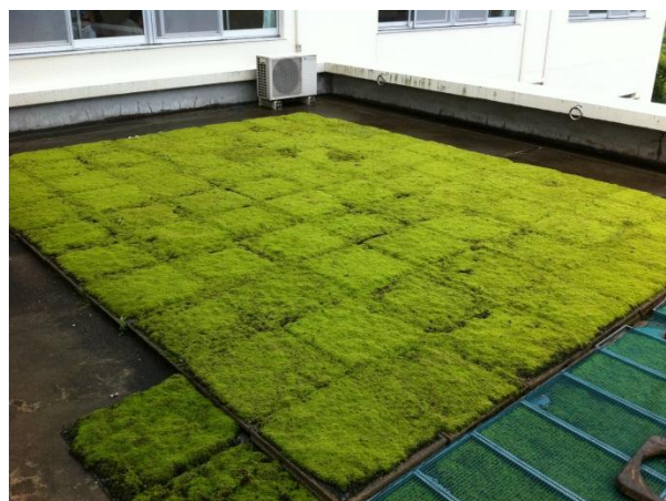
屋上緑化 20 m 2 (神奈川県三浦市)
